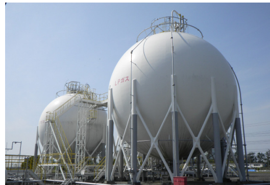
LP ガスプラント
