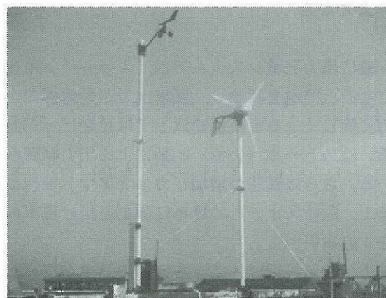
図1 風力発電機と風速計
