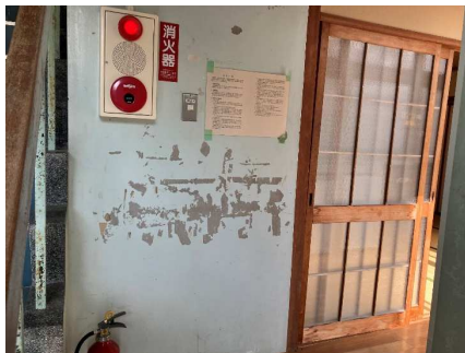
図4 内装の剥がれ
