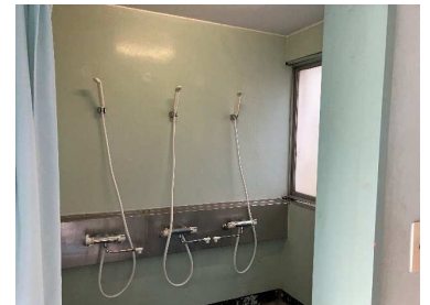
図3 老朽化したシャワースペース
