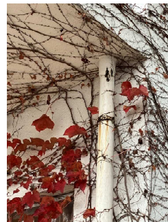
図5 雨水管の腐食
