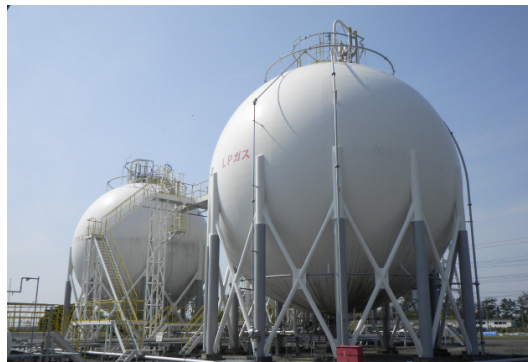
LP ガスプラント
