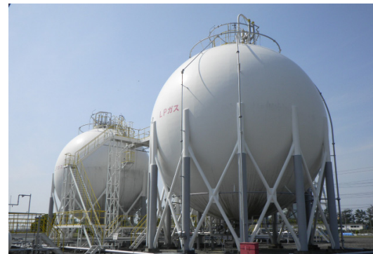
LP ガスプラント
