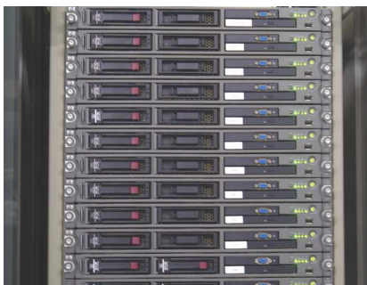
サーバ機とルータ機
